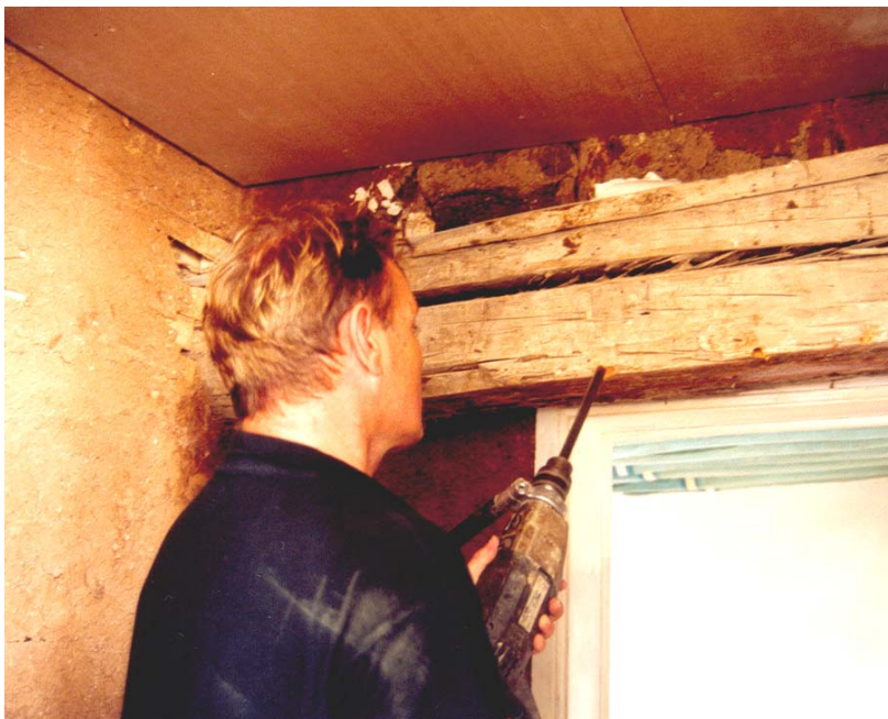
Abbildung 8 Probe 24, Probennahme mit Bohrgerät. Pappelbalken in der Wand des kleinen Raumes neben der neuen Küche der Direktorenwohnung, tragender Balken, ca. 25x25cm. Wahrscheinlich handelt es sich um einen wiederverwendeten Balken, der evtl. vom Iwan stammt.
