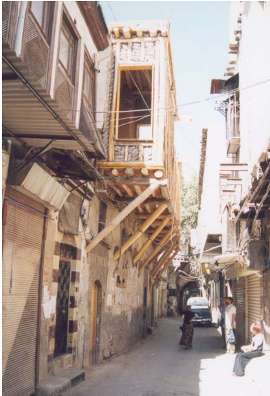
Abbildung 6 Frontseite der Aqqad-Hauses zur Strasse hin. Renovierter ‚Erker‘ (oder ‚kanap‘) des Aqqad-Hauses aus Pappelholz und Lehmziegeln.
