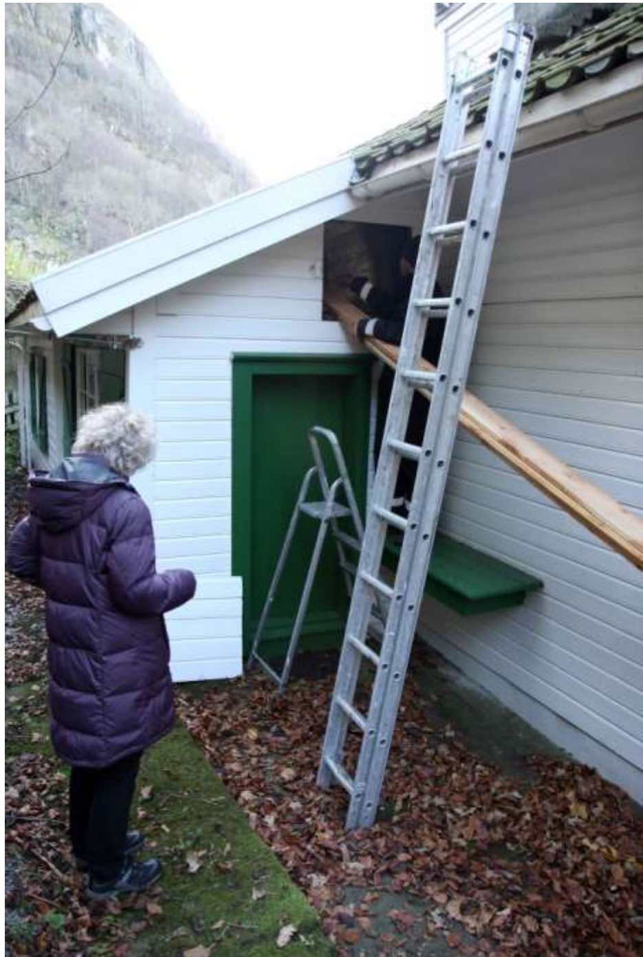
Prøveudtagningen fra krybeloft over hovedhusets tilbygning. Foto: Niels Bonde
